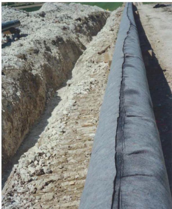
Protezione di gasdotto
