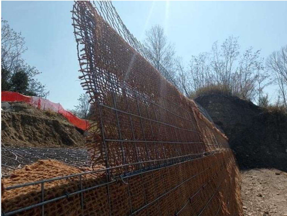
Foto 13 – Esempio di posa corretta: i ricorsi sono posati rispettando il “dente” di appoggio.
